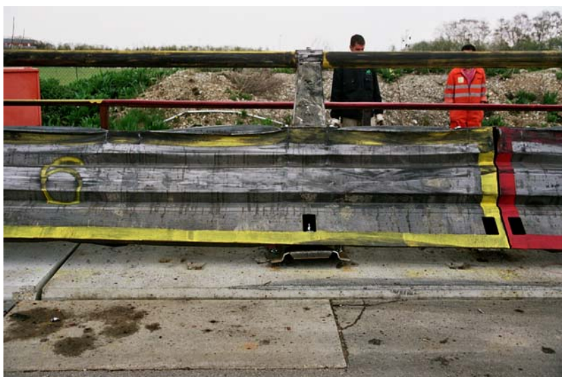
Bild 42: Schäden am Element 6
