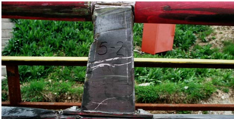
Bild 47: Schäden und Längsver- schiebung an der Rohrauf- hängung 5-2
