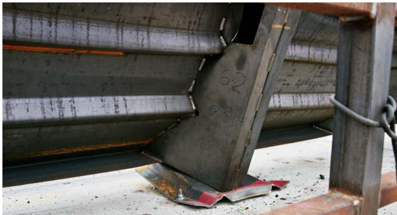
Bild 50: Schäden an der Veranke- rung der Fußplatte 6-2 (Rückseite)
