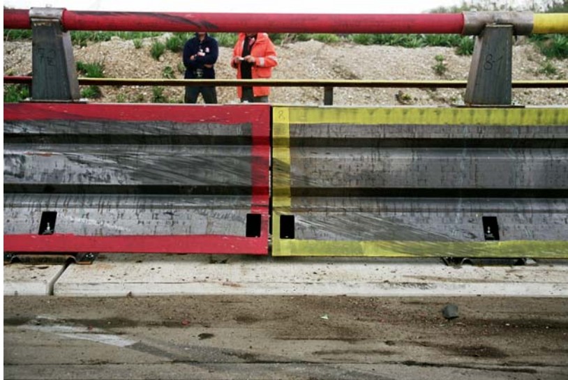
Bild 44: Ende der Kontaktstrecke und Schäden am Element 7/8
