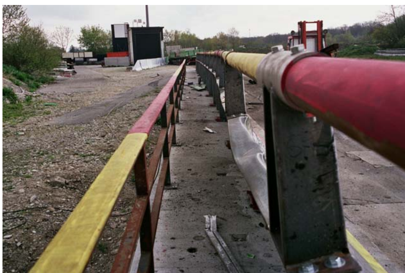
Bild 37: Schäden an der Schutzeinrichtung (Rückseite)
