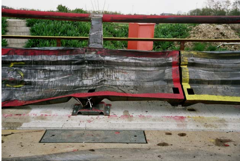
Bild 41: Schäden am Element 5
