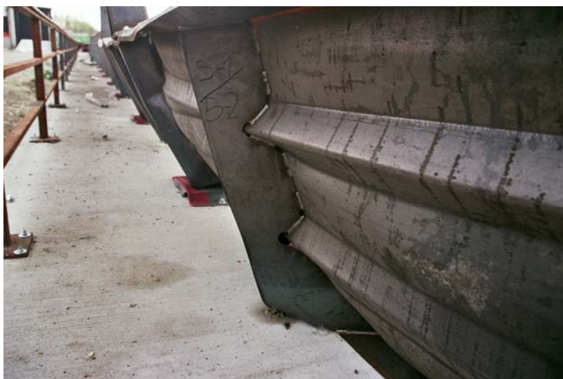
Bild 39: Schäden an der Schutzeinrichtung (Rückseite)
