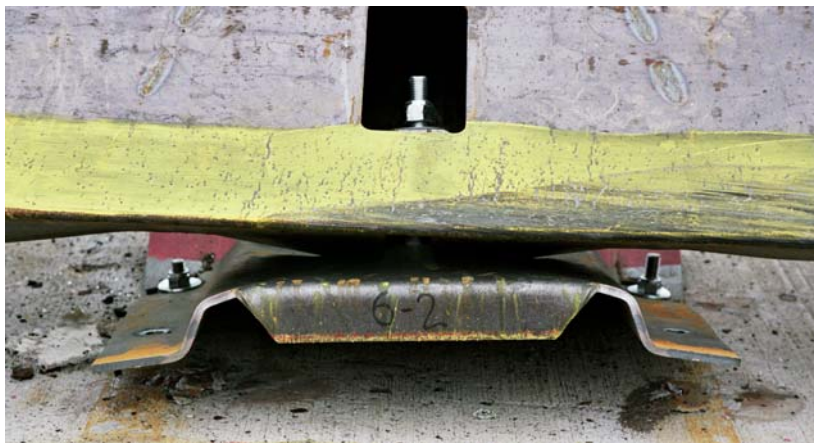
Bild 49: Schäden an der Veranke- rung der Fußplatte 6-2 (Vorderseite)
