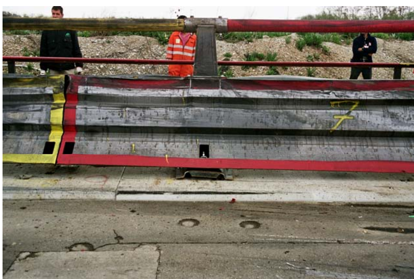
Bild 43: Schäden am Element 7
