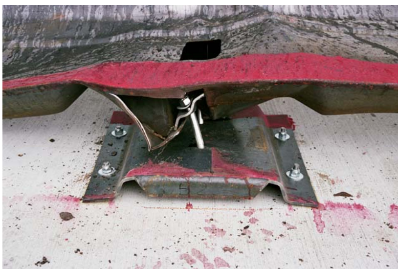
Bild 46: Schäden an der Veranke- rung und Fußplatte
