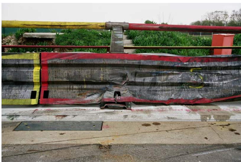
Bild 40: Beginn Kontaktstrecke und Schäden am Element 5
