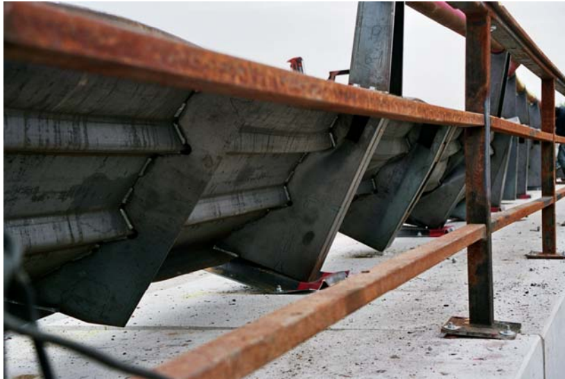
Bild 38: Schäden an der Schutzeinrichtung (Rückseite)
