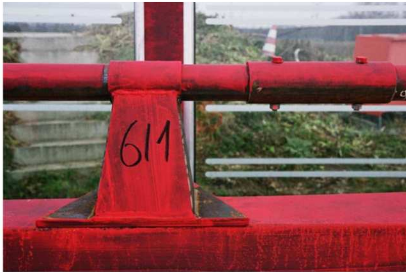
Bild 35: Längsverschiebung an Rohraufhängung an Verankerung 6-1
