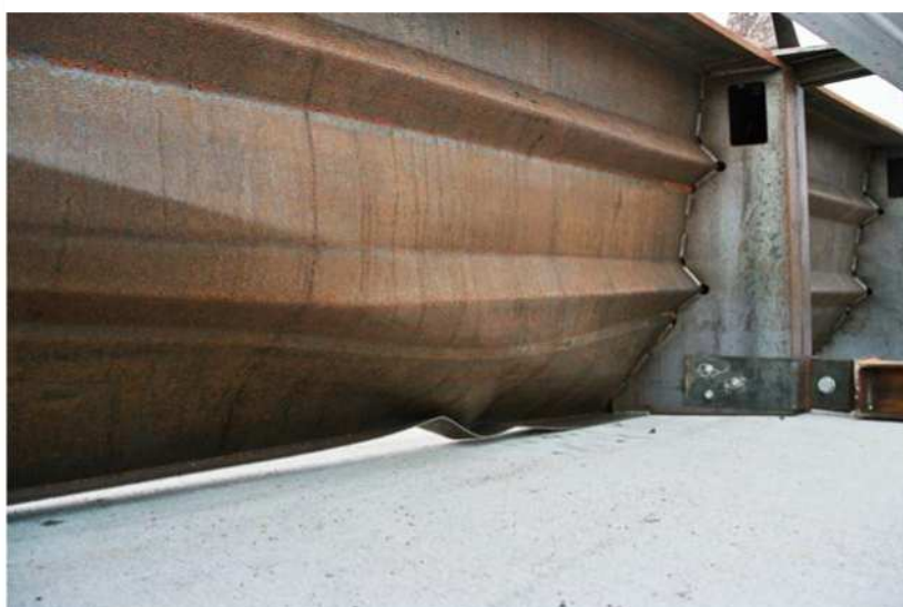
Bild 34: Rückseite Frontblech an Verankerung 6-1
