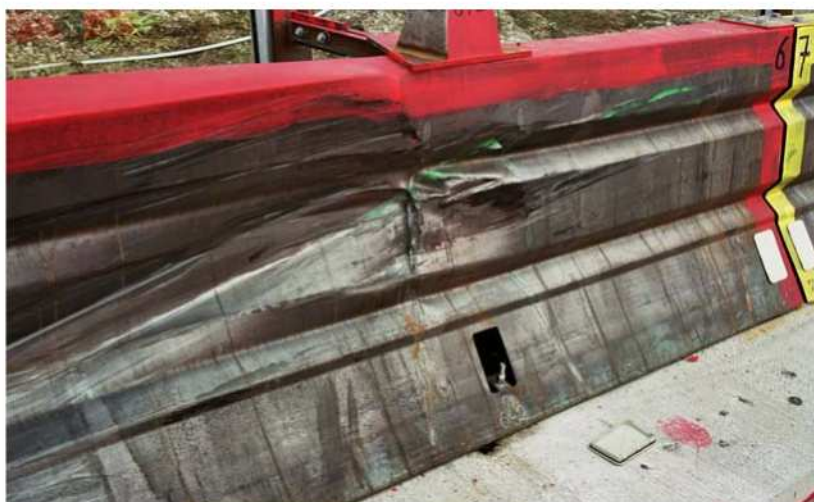
Bild 31: Schäden an der Schutzeinrichtung
